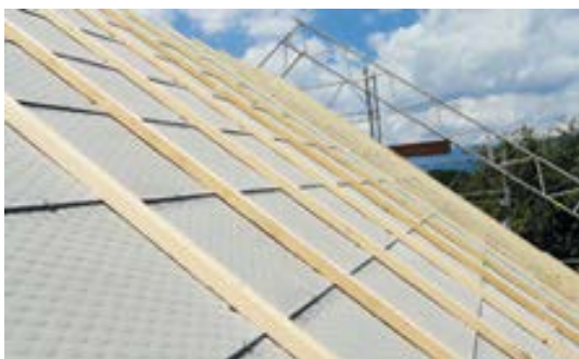
Abb. 9 Geschupptes Plattenunterdach (Faserzement / Holz) Kann Asbest enthalten (älter als 1991). Durchdringungen durch das Plattenunterdach funktioniert nur an bestimmten Stellen (Herstellerangaben).
