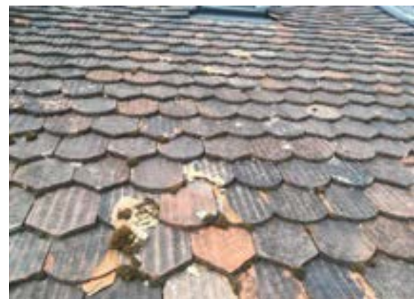
Abb. 5 Leichte abgesplitterte Ziegel über die ganze Fläche: Hier empfiehlt sich eine Dachsanierung vor der Solar-Montage.
