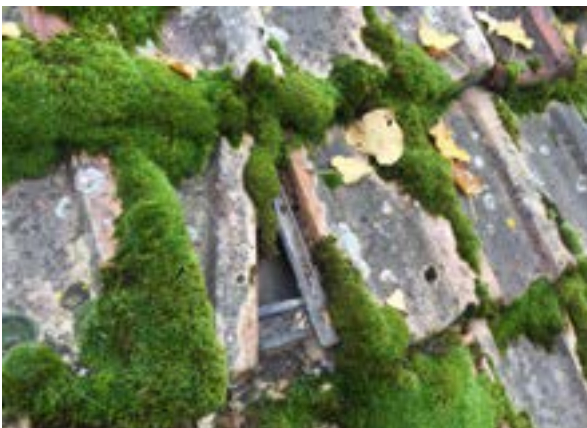
Abb. 2 Moosbefall/Sanierungsbedürftig: Dieses Dach muss vor der Solar-Montage saniert werden!
