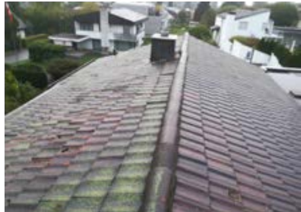
Abb. 4 Einzelne abgesplitterte Ziegel: Hier empfiehlt sich eine Dachreparatur vor der Ausführung
